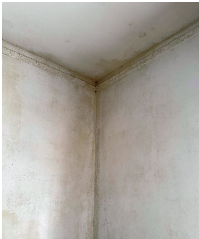
Figura 5.5. Muffa su un angolo interno di locale riscaldato, presente su pareti e solaio. È evidente la presenza più marcata sulla linea verticale di connessione tra le pareti e tra pareti e soffitto, in cui si manifestano maggiormente gli effetti del ponte termico (foto dell'Autore)
