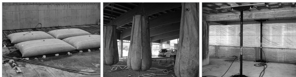
Serbatoi ad acqua
